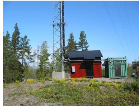
Simpevarp. Sitter på stora masten vid Simpevarps kärnkraftverk, 10 m.ö.h och ca 1 km från den sammanhängande kustlinjen. Omgiven av gles tallskog.
